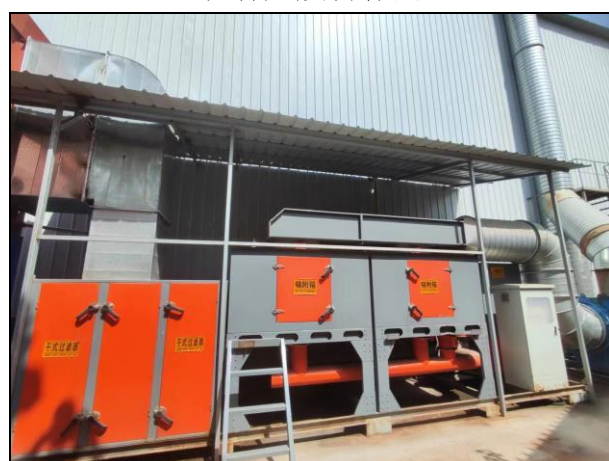
现有干式过滤器+催化燃烧装置
