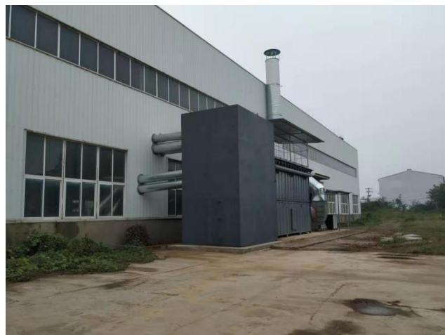
现有工程废气处理设备
