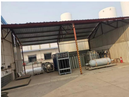
四氯化硅储罐区
