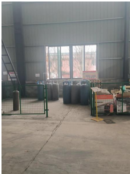
车间内气瓶储存区
