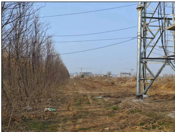
新建蒸汽管线现状
