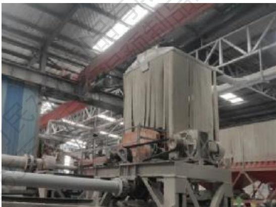
水泥管搅拌机集气罩
