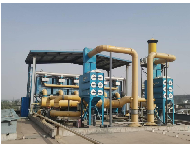
依托现有滤筒除尘器+RCO
