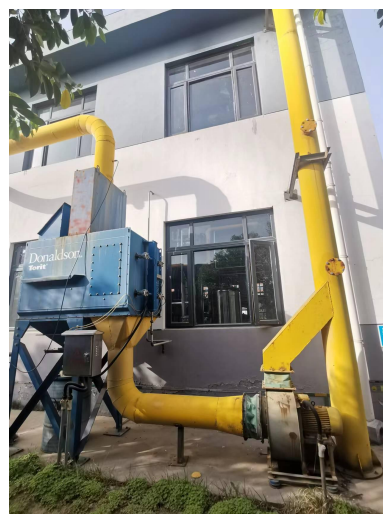
依托现有滤筒除尘器
