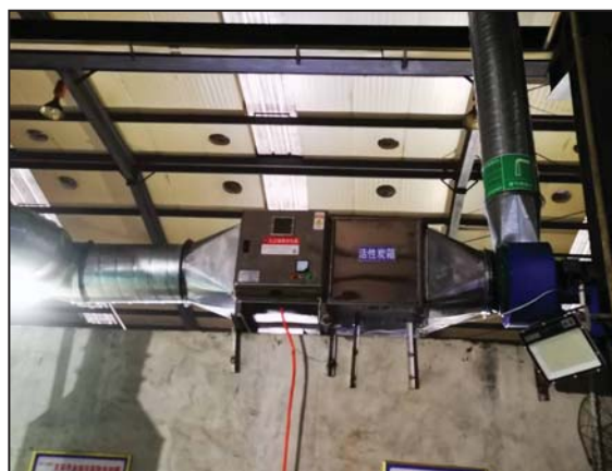
清洗设备后续废气治理设施及排气筒
