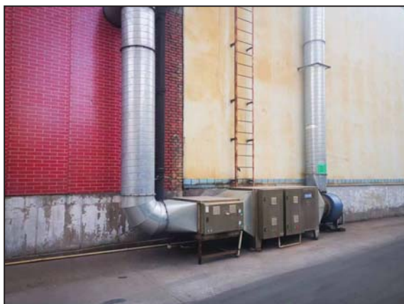
锻造车间西侧废气治理设施及排气筒
