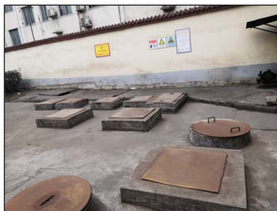
生活污水一体化处理设施
