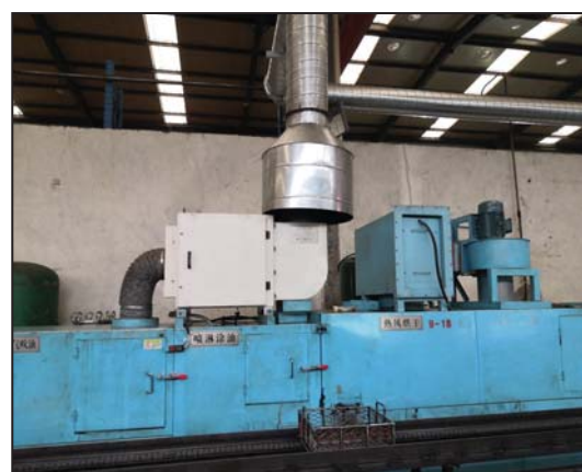
清洗设备自带油烟净化净化设施
